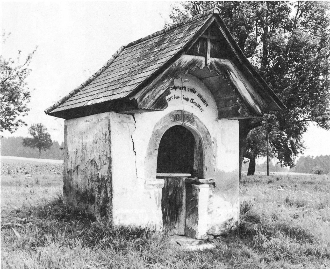
So angeschlagen sah das Chäppali Warlosen vor seiner Restaurierung aus.
