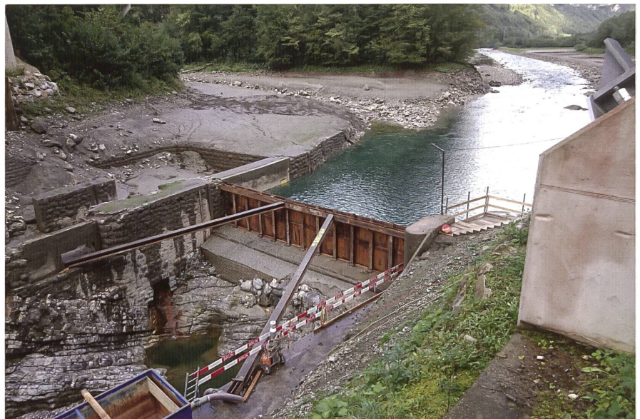
Bild 9: Bauwand im Oberwasser des Stauwehrs Schlattli auf der Schwelle der alten Wasserfassung zur Umleitung der Muota durch den Umleitstollen (Aufnahme während des Einstauversuchs).
