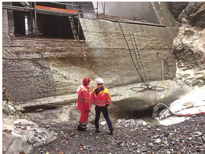
Bild 20: Dammfuss mit Abrasionserscheinungen am Wehrbeton sowie Auskolkungen. Oben rechts ist der Auslauf der Haupt- und Regulierschütze, oben links der Auslauf der beiden Grundablässe zu erkennen.
