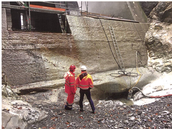
Bild 20: Dammfuss mit Abrasionserscheinungen am Wehrbeton sowie Auskolkungen. Oben rechts ist der Auslauf der Haupt- und Regulierschütze, oben links der Auslauf der beiden Grundablässe zu erkennen.
