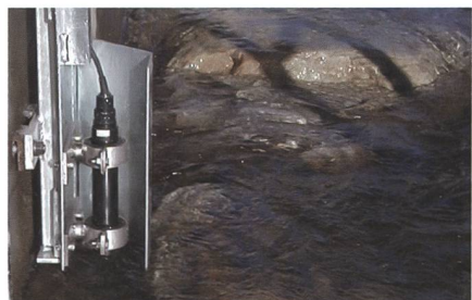
Bild 3: Funktionsprinzip der optischen Trübungssonde (oben) und installierte Sonde (unten). Foto: A. Grasso.
