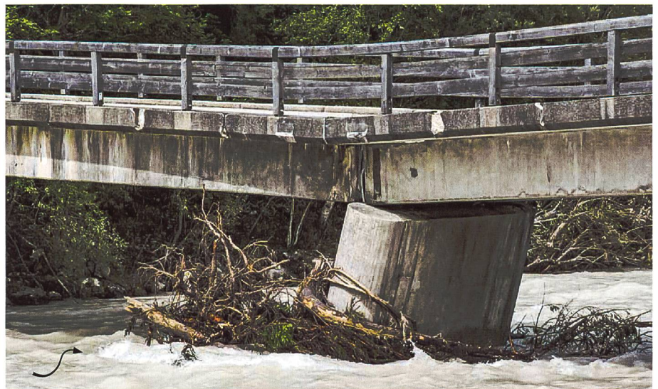
Bild 1. Verklausung an einem Brückenpfeiler und strukturelle Versagenswahrscheinlichkeit aufgrund von Kolk (Foto: bridgemastersinc.com ).
