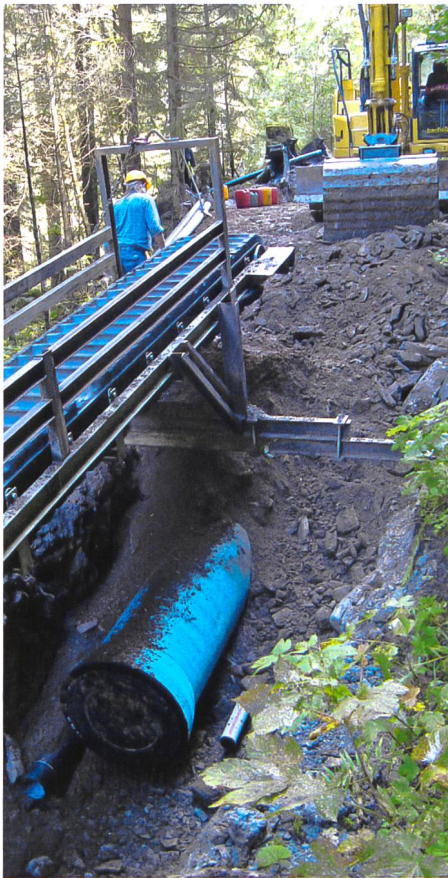
Bild 17. Bau der Druckleitung DN600 im alten Fermelweg; der Aushub wird direkt wieder für die Hinterfüllung des vorher verlegten Rohres benutzt (Aug. 2014).
