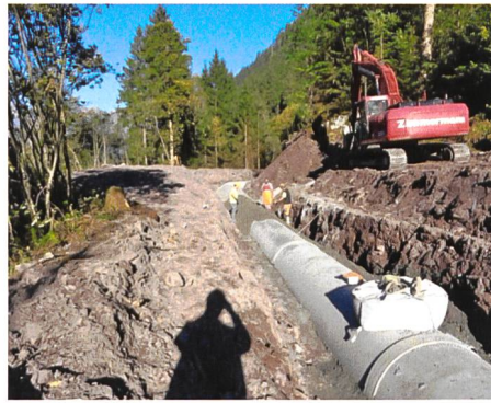
Bild 3. Die neue Druckleitung zwischen der Apparatekammer Bruggwiti und dem Druckstoßen.
