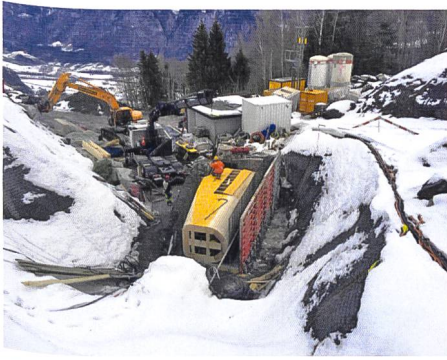
Bild 8. Übergang vom Stollen Marmiez (unten) und der Apparatekammer (oben) mittels eines vor Ort erstellten Konus aus Beton.
