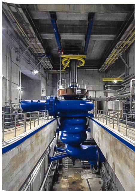
Bild: Die neuen Pumpturbinengruppen sind nun in Betrieb (Foto: David Picard).
