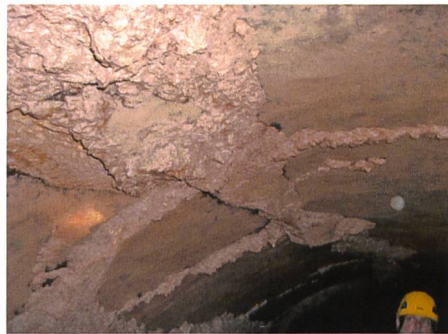
Bild 4. Vor der Sanierung: Einblick in den einbruchgefährdeten Druckstoßen.
