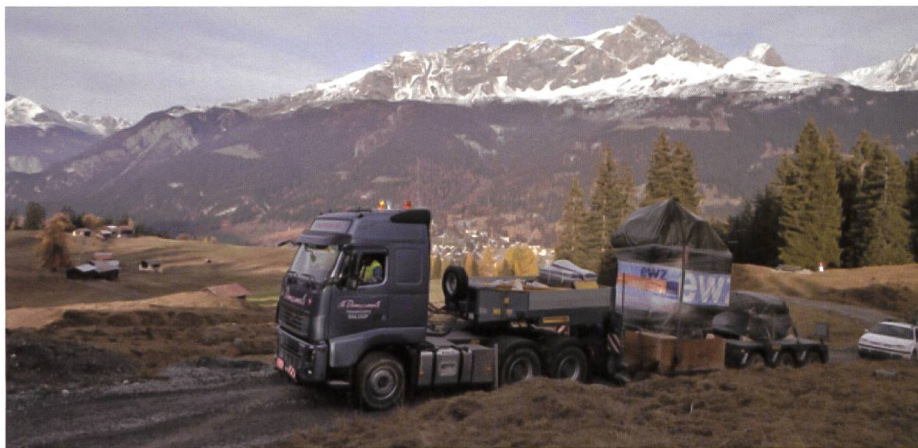
Bild 1. Anlieferung des 30 Tonnen schweren Generators von Savognin zur neuen Kraftwerkszentrale Nandrò (Quelle: ewz)
