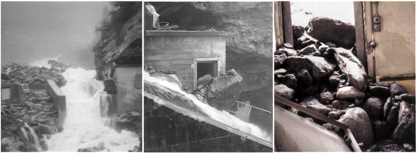
Bild 2. Beschädigte Wasserfassung Riedbach in Grächen (Mattertal, Mattmark AG) als Folge eines Wasserausbruches im Riedgletscher am 08. August 1989 (Fotos: Kraftwerke Mattmark AG).
