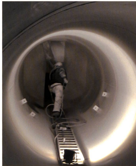
Figure 9. Travaux de protection anticorrosion en dessous des vannes de la purge Sud.
