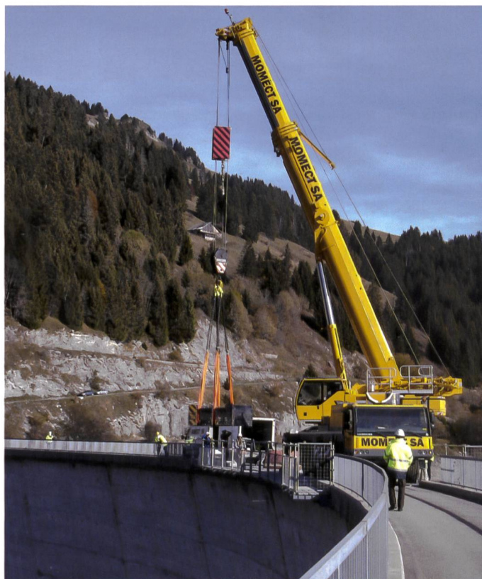
Figure 7. 29 octobre 2009: Essai de levage à 28 t sur le couronnement Nord, qui confirmait les concepts théoriques in situ.
