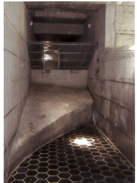
Bild 19. Entkieser mit Schmelzbasaltplatten, unten rechts Spüleleitung, oberhalb die Dotierwasserleitung sowie oben rechts der Überlauf. Vorne ist der Fischabweisungsrechen zu sehen. Hintenan folgt der Sandfang.
