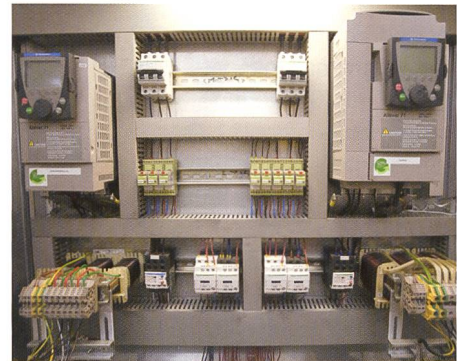
Bild 3. Der Schaltschrank mit der neu installierten Frequenzumrichter-Steuerung.
