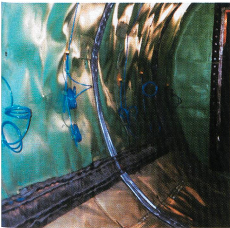
Bild 1. Noch während der Meeresboden gefroren ist, bekommen die Querstellen (Fluchtwege) im Westerscheldetunnel eine wasser-dichte Auskleidung aus FPO-Folie, die punktförmig am Untergrund befestigt wird (Foto: PeinigerRöRo).
