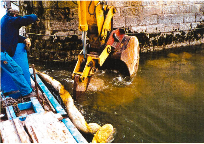
Bild 6. Entscheidend für die Wirkung des Kolksschutzes ist die Qualität der Ausführung. Die Blöcke werden unter Wasser einzeln versetzt (Aarebrücke bei Koblenz).
