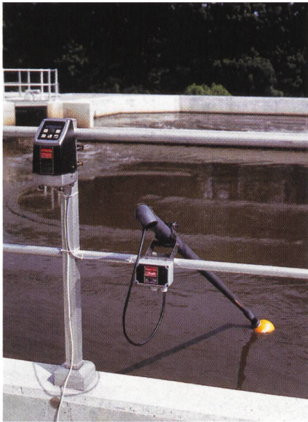
Bild 3. Am Geländer des Belebungsbeckens ist ein Evita-Oxy-Messumformer sowie ein PVC-Rohr mit Schwimmerkugel und eingebautem Sauerstoffsensor angebracht. Die Messgenauigkeit beträgt 0,5% vom Messbereichs-Endwert (Werkfoto: Danfoss AG).
