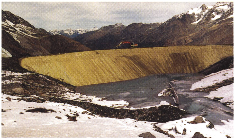
Figure 5. Revêtement du talus amont avec un sol stabilisé pour l'aménagement de production de neige artificielle de Othmarhang à Saas Fee VS (photo: A. Kobelt).
