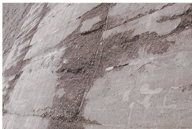
Figure 5. Dégâts dus au gel, barrage de Cleuson, parement amont.
