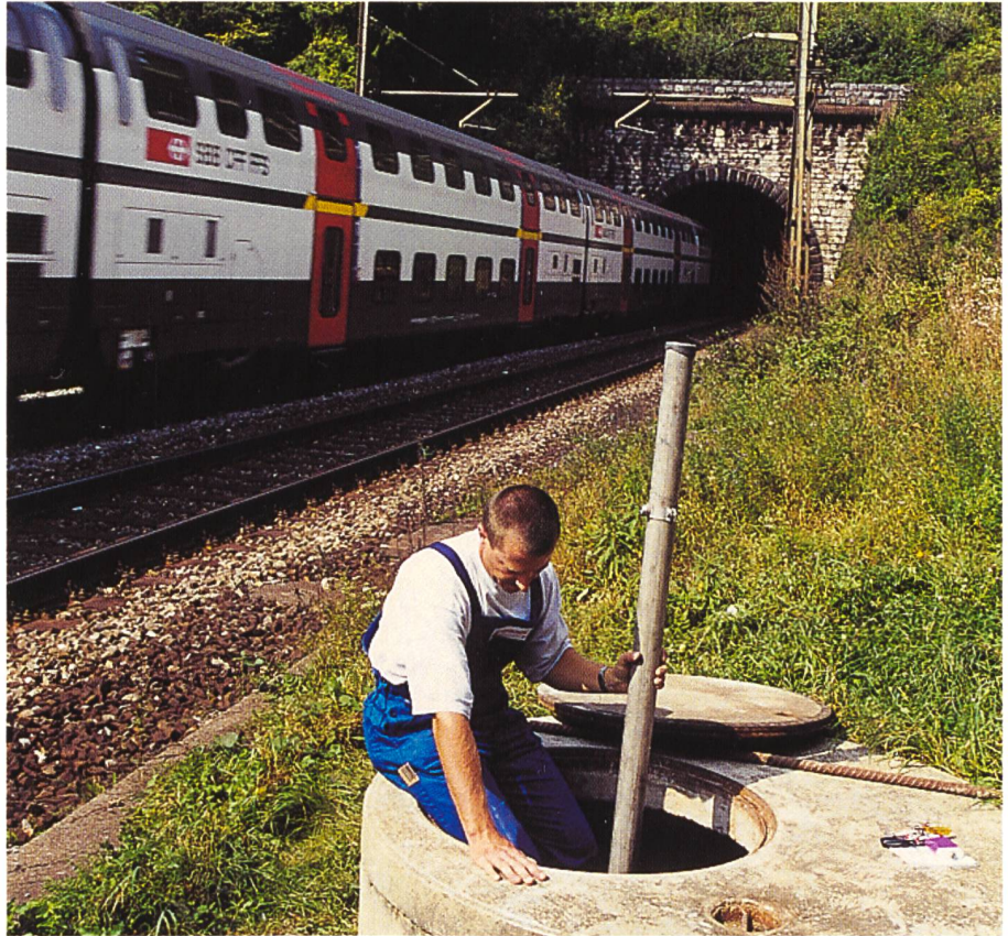
Bild 1. Aus dem Hauenstein-Tunnel sprudeln 2500 Liter Warmwasser in die Fassung – pro Minute.
