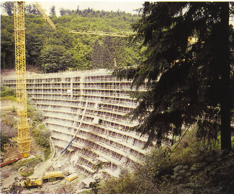
Bild 1. Instandsetzungsarbeiten an der Talsperre Neustadt: Das RUX-Rohr-Kupplungs-Gerüst folgt den Krümmungen der denkmalgeschützten Bruchsteinmauer.
