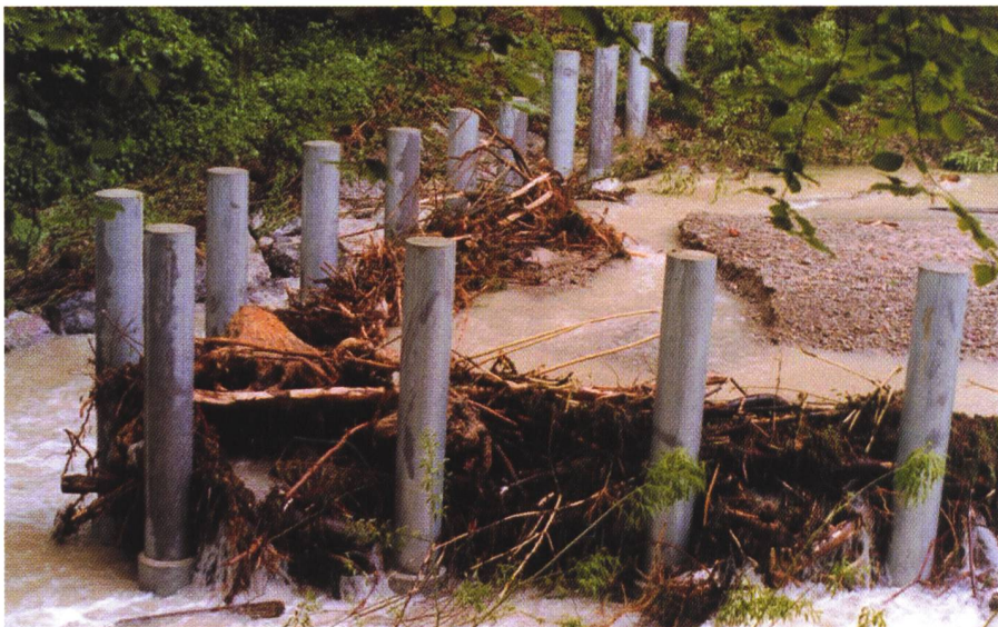
Bild 3. Beaufschlagter V-förmiger Schwemmholzfang am Chämtnerbach/Kanton Zürich nach dem Hochwasser vom 13. Mai 1999 (Fließrichtung von rechts; Bildnachweis: Amt für Abfall, Wasser, Energie und Luft des Kantons Zürich).
