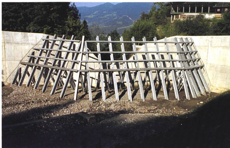
Bild 1. Rechenkonstruktion im Geschiebesammler am Dorfbach Sachseln/Obwalden (Blick in Fließrichtung).
