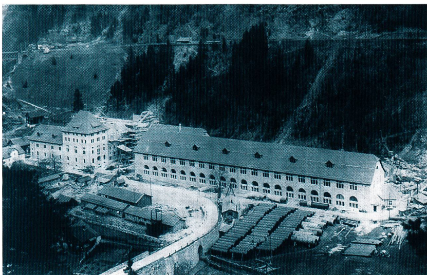
Bild 4, links. Das Kraftwerkgebäude während der Bauzeit (26. März 1921). Rechts neben der Plattbrücke sind die Rohrschüsse für die Druckleitung gelagert.
