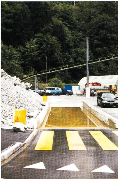
Bild 31. Im Brindli wurde eine Lastwagen-Waschanlage installiert.
