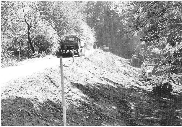
Bild 6. Stauanlage Gübsensee der St. Gallisch-Appenzellischen Kraftwerke AG. – Verstärkung des Westdammes durch Schüttung. Absenkung der Sickerlinie durch Drainageleitungen am Dammfuss (1986/87).
