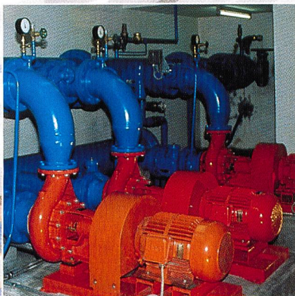
Pumpwerk in Wädenswil
