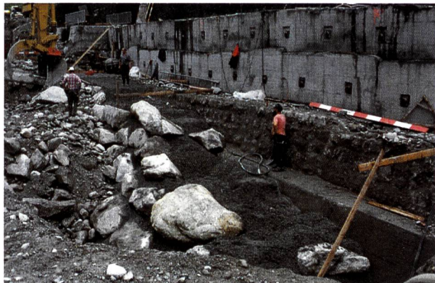
Bild 7. Hauptschutzelement C. 2fach verankerte Elementwand unterhalb der SBB-Stützmauer. Gewichtsmauer, etappenweise ausgeführt; Integrieren einer alten Bruchsteinmauer, welche beim Aushub zum Vorschein kam.
