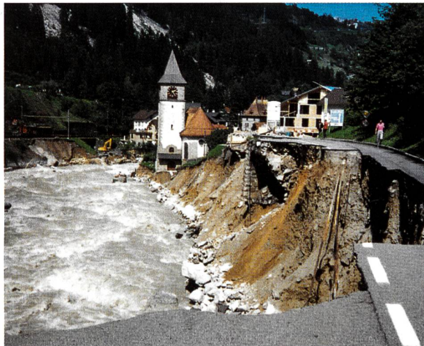
Bild 2. Zerstörte Kantonsstrasse südlich Gurnellen.
