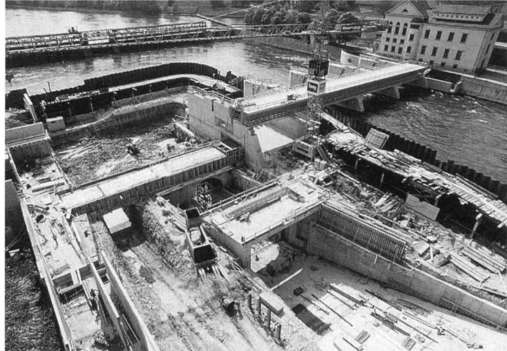
Bild 6, rechts. Baugrube Maschinenhaus. Infolge heikler Untergrundverhältnisse musste diese etappiert werden. Die Aare ist während dieser Bauphase durch das neuerstellte Wehr umgeleitet, die Schützen sind noch nicht eingebaut.
