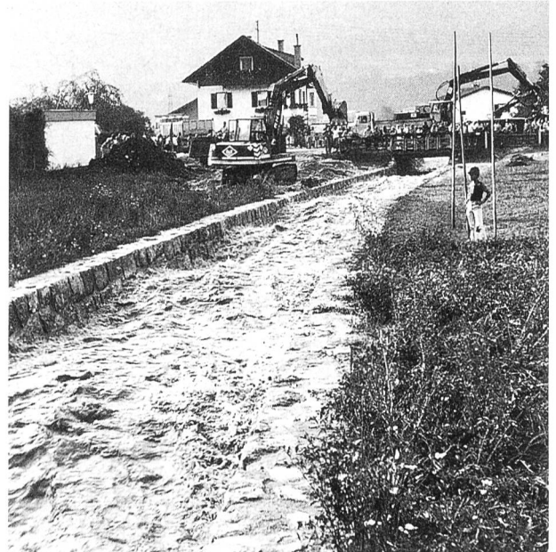
Bild 2. Volderbach bei Hochwasser nach Dämpfung der Wellen mittels Stangen und Baggern (Bild: H. Lang).
