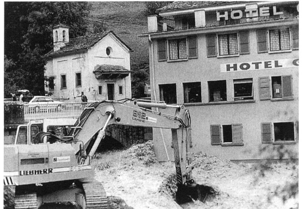
Bild 3. 1994er Hochwasser am Chrumbach/Simplon. Zwei Bagger halten den Brückendurchlass bei Gabi frei (Bild: J. Escher).
