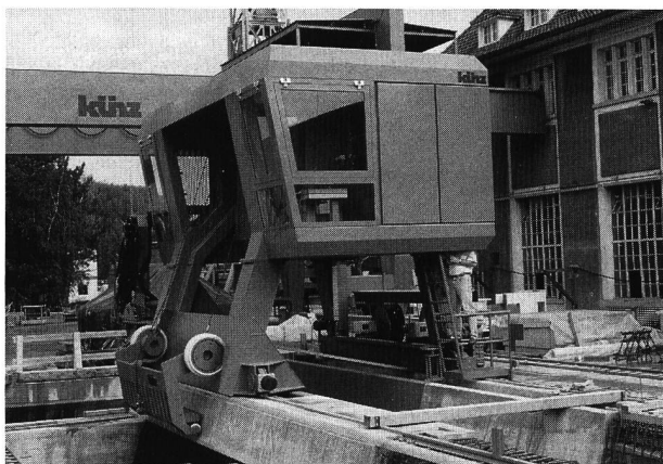
Die vollautomatische Rechenreinigungsmaschine in Augst, dahinter der Portalkran 85/20 t.
