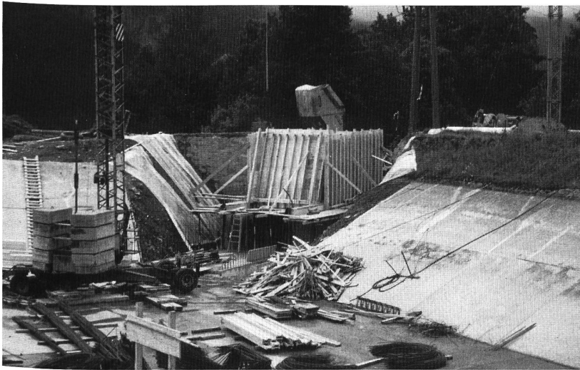
Bild 3. Bau des Entnahmebauwerks im Ausgleichsbecken Luchsberg für das Kraftwerk der Spinnerei Murg AG.
