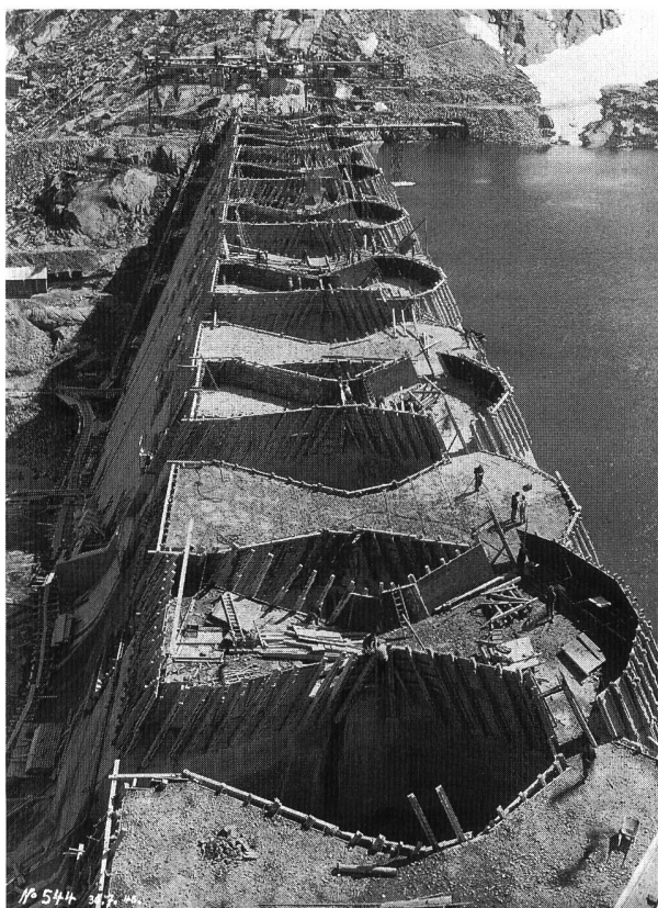
Figura 3. Diga Lucendo durante la costruzione, estate 1946. Bild 3. Staumauer Lucendo während des Baues im Sommer 1946.
