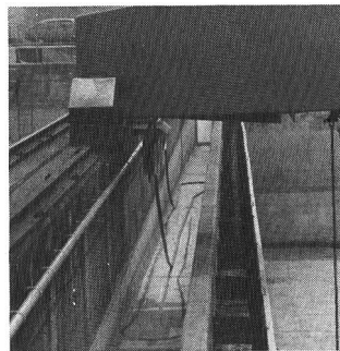
Räumer mit Klärbecken ARA Zofingen
