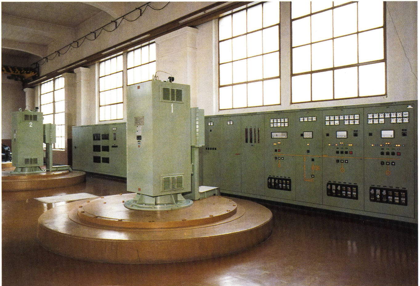
Synchrongenerator 710 kVA, 525 V, 1500 U/min und Getriebe 170/1500 U/min, angetrieben mit Kaplanmaschine
