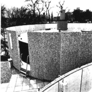
Faulanlage, Vilette, Gent
