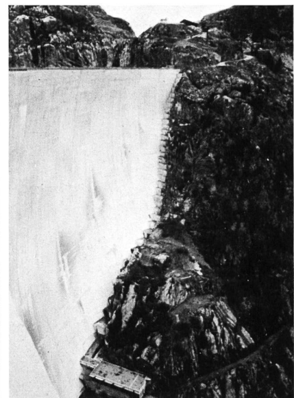
Bild 7. Linkes Widerlager der Staumauer Emosson. Dieses Bild wurde vorsorglich als Grundlage für die Kontrolle und Überwachung der Abwitterung des Sperrenwiderlagers aufgenommen.
