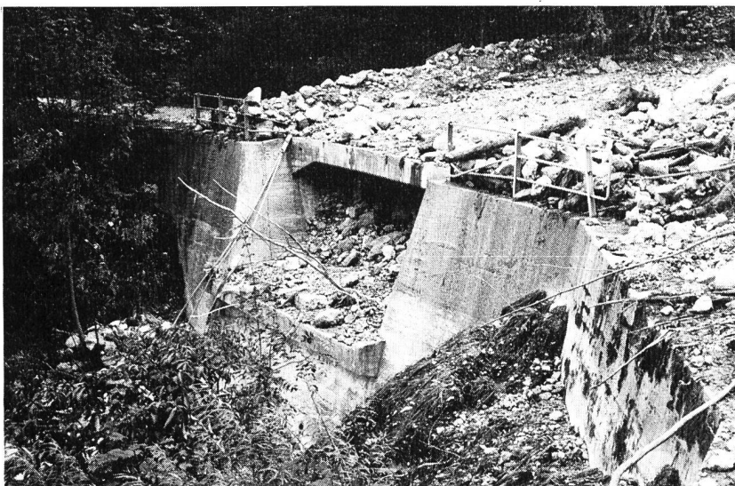
Bild 3. Die Buochser Rübi bei Buochs/Kt. Nidwalden ist ein Runsengebiet, das in den letzten Jahrzehnten saniert wurde. Durch das Unwetter vom 16./17. August 1981 entstanden erneut starke Schäden im Einzugsgebiet.
