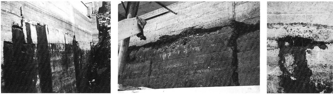
Bilder 3, 4 und 5. Staumauer Schöni. Einzelheiten der Betonschäden auf der Wasserseite.
