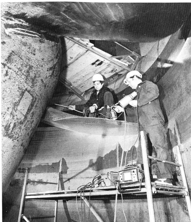
Bild 4. MT- und UT-Prüfung in einer Kaplan-turbine im Kraftwerk Schaffhausen. MT: Magnetrisprüfung; UT: Ultraschallprüfung. Werkfoto +GF+
