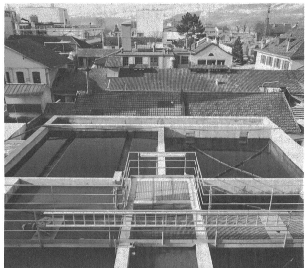
Bild 3. Absetzanlage mit Vorflocker und Schräglklärer (Firmenich AG).
