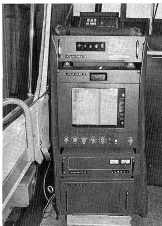
Bild 5. Das Echolot-Gerät ist im Messboot der EDF eingebaut.
