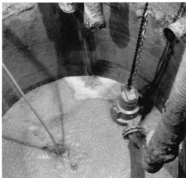
Neu entwickelte Tauchmotorpumpe KRT in der Presswasserhebestation einer Papierfabrik.
