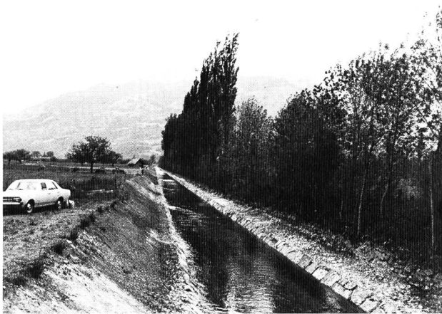
Bild 7. Vertiefter und verbreiteter neuer Saarkanal. Der linksufrige, alte Baumbestand konnte geschont werden. Rechts im Bild erkennt man die kleinen Steine der alten Pflasterung des vor rund 130 Jahren erstellten Kanales und damit die Tiefe der damaligen Grabensohle.
