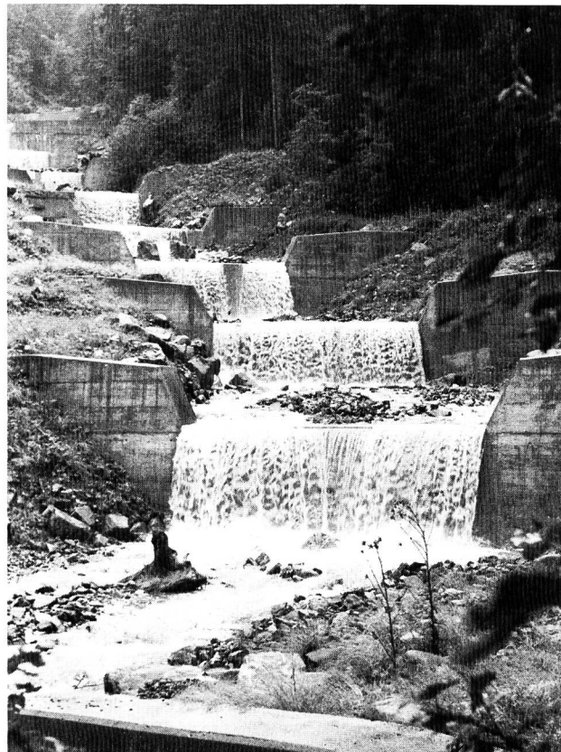
Bild 1. Die Sanierung des Nidlaubaches im Kanton Schwyz. Oberlauf: Sohlenabtreppung im Haupterosionsgebiet Schlagentobel mit schlanken Eisenbetonsperren.
