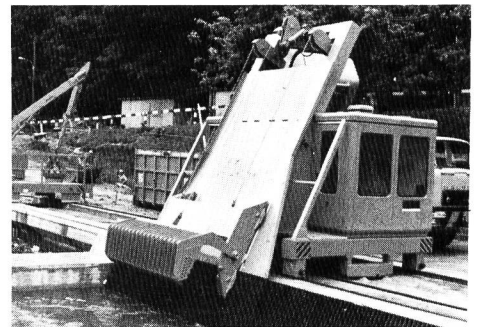
Im Kraftwerk Felsenau/BE
