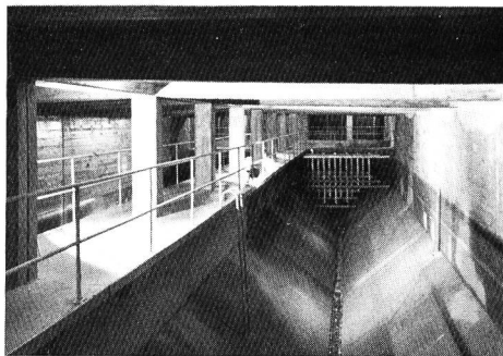
Sandabzugsvorrichtung BIERI in Kaverne eingebaut, Sedrun
