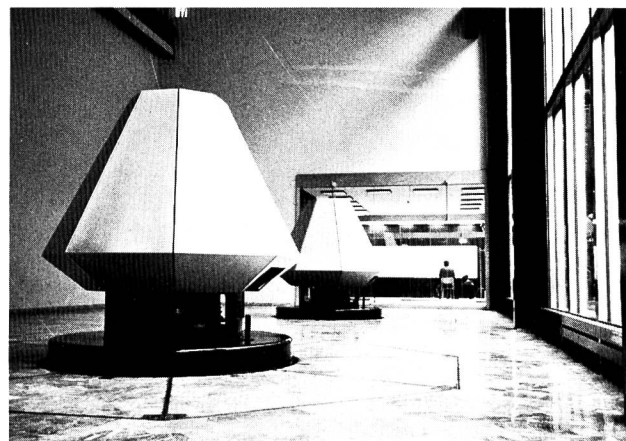
Bild 2. Der neue Maschinensaal des 1969/70 erneuerten Kraftwerks Campocologno. Die mittlere jährliche Erzeugungsmöglichkeit konnte von 112 Mio kWh auf 174 Mio kWh gesteigert werden. 1 Druckleitung, Durchmesser 1800/1700/1600 mm; 2 x 23 950-kW-Francis-turbinen; Nettofallhöhe 416 m; nach späterem Aufstau wäre eine Leistung von 2 x 24 800 kW möglich [1].
