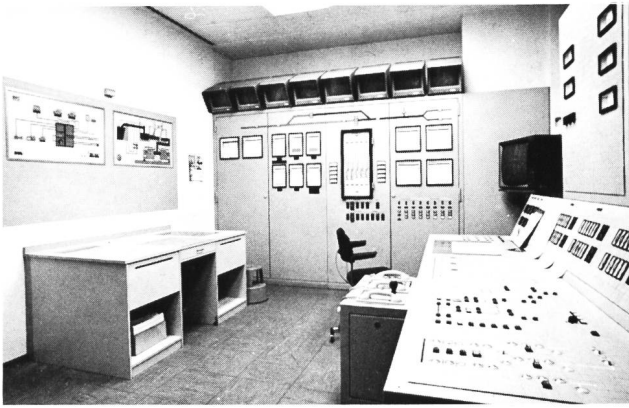
Bild 18. Zentralwarte im Rheinkraftwerk Albruck-Dogern für die Fernsteuerung und Fernüberwachung des Maschinenhauses, des Wehrs, des Aubeckens und des Pumpwerks Full. Warte rechts: Maschinensteuer- und Instrumententafel. Bildmitte: Wasserwirtschaft und Fernsehen. Links: Protokollschreiber für die Datenverarbeitungsanlage.
