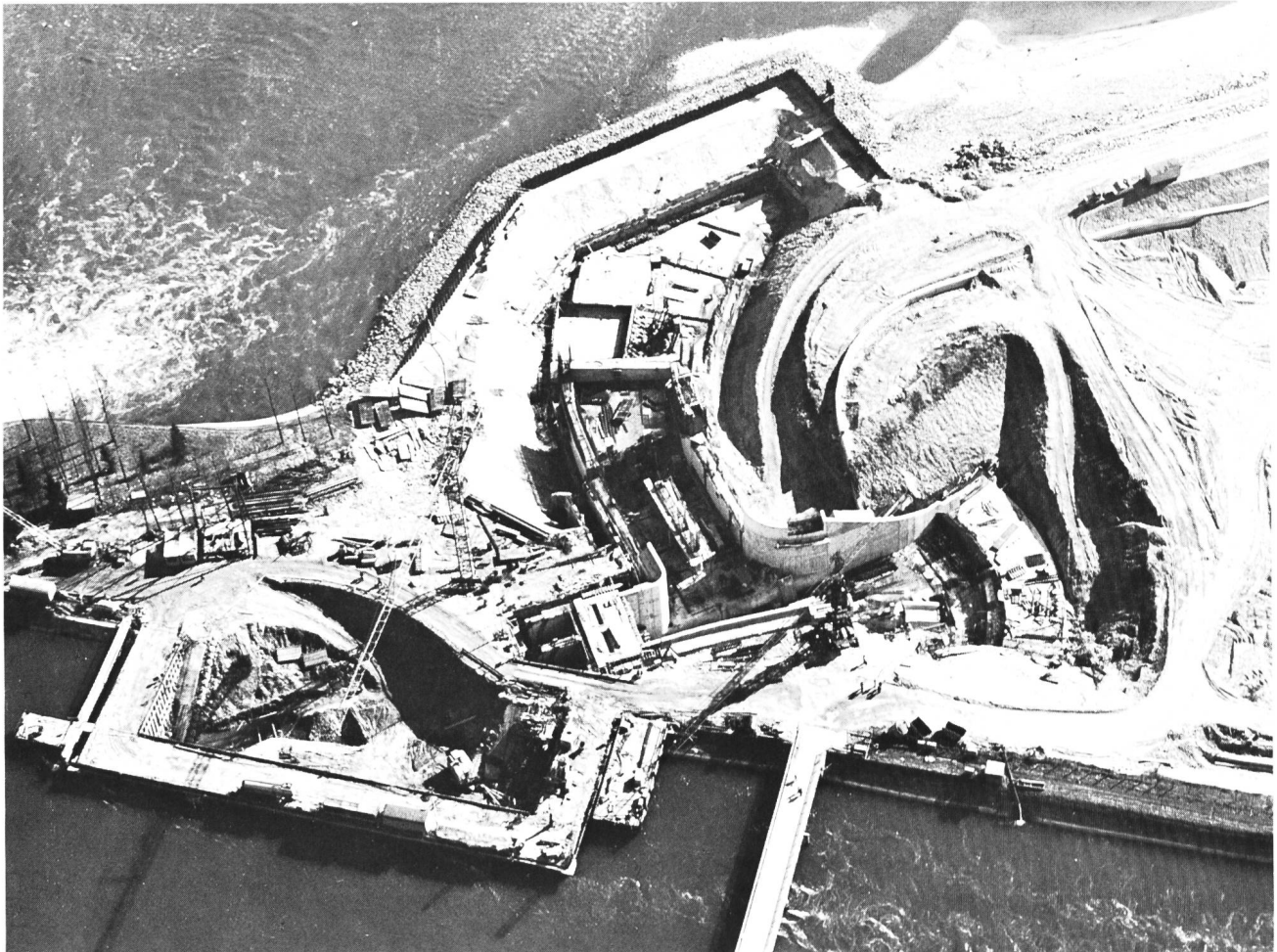
Bild 11. Flugaufnahme der Baugrube des Ein- und Auslaufbauwerkes vom 6. März 1977. Der Oberwasserkanal des Kraftwerks Albruck-Dogern verläuft am untern Bildrand in Fließrichtung von links nach rechts. Das Stauwehr würde am linken Bildrand anschliessen. Der Rhein verläuft im obern Bildteil von links nach rechts. (Foto Sokolowski, Konstanz)
