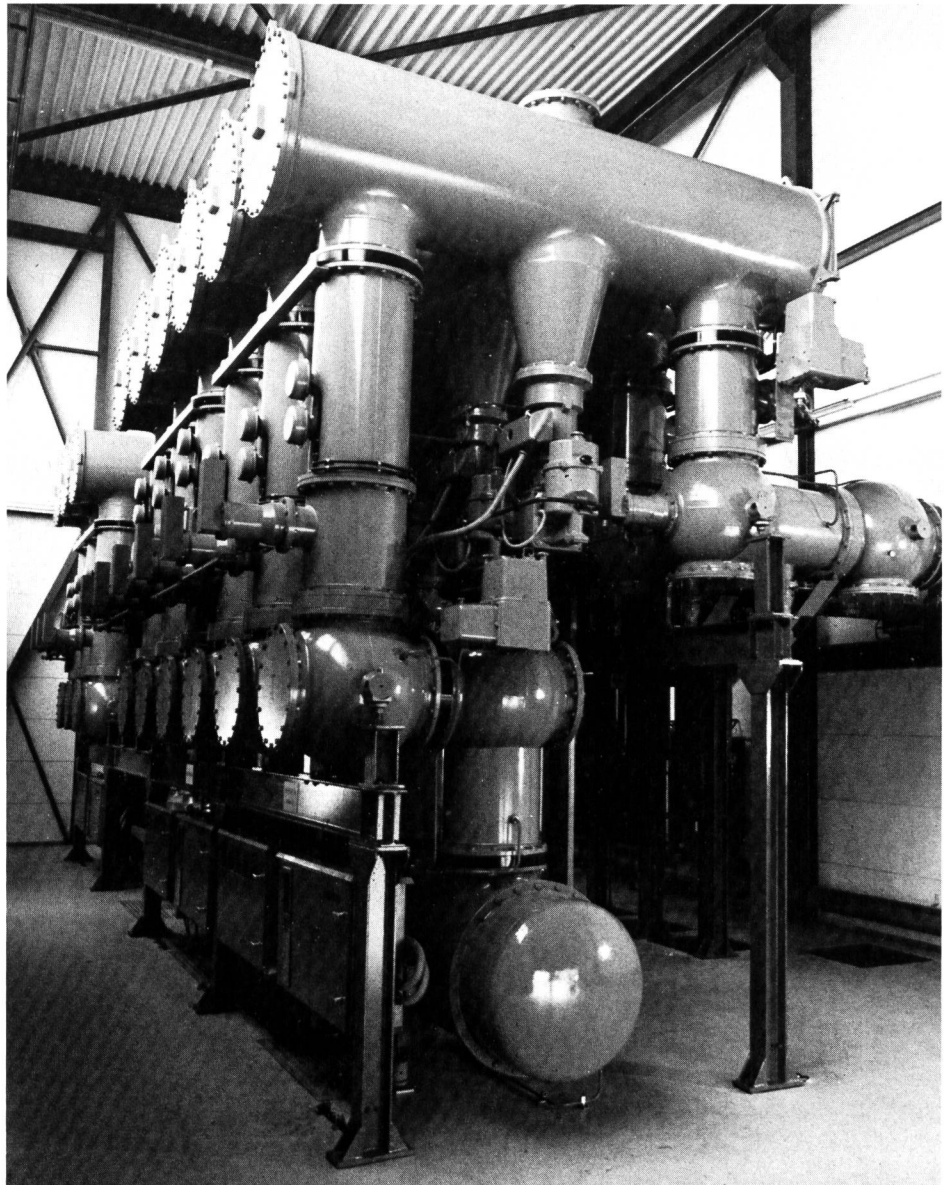
SF 6 -isolierte Schaltanlage für 245 kV
