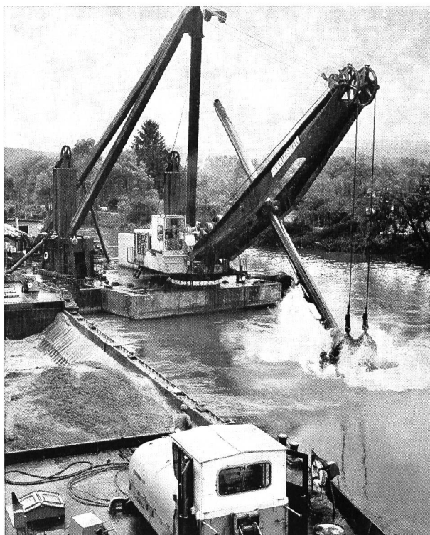
Bild 5 Der amerikanische Manitowoc-Schwimmbagger bei der Arbeit im Nidau-Büren-Kanal. Zurzeit ist er im 24stündigen Tageseinsatz in Finnland tätig!
