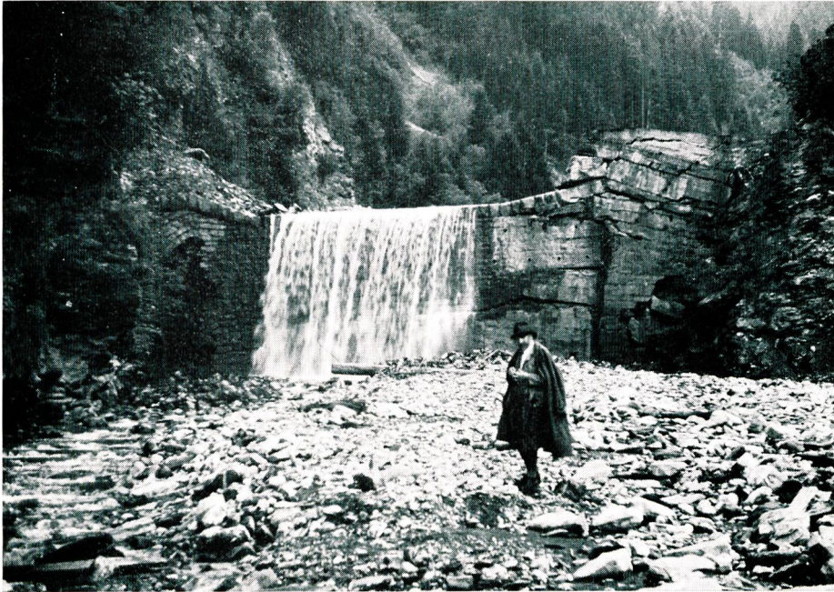
Bild 2 Alte Sperre in der Nolla. Der linke Sperrenflügel wurde von dem sich in Bewegung befindlichen Hang nach aufwärts gedrückt.
