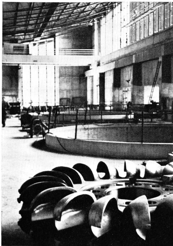
Bild 10 Blick in die Zentrale Châtelard/Vallorcine an der französisch-schweizerischen Grenze
