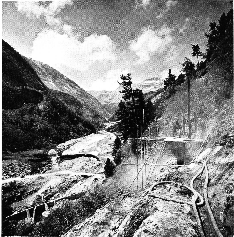
Bild 3 Aushubarbeiten für die Sperren Galgenbichl des Vorseichers Wastlbaueralm im Malatal (Werkphoto: Oesterreichische Draukraftwerke Aktiengesellschaft/Aufnahme Raab)
