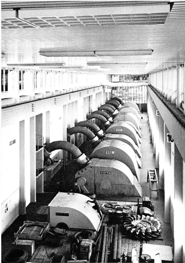
Bild 6 Zemmkraftwerke: Krafthaus Mayrhofen, Maschinenhalle (Werkphoto vom 6. Oktober 1970 der Tauernkraftwerke AG/Aufnahme W. Zabel)
