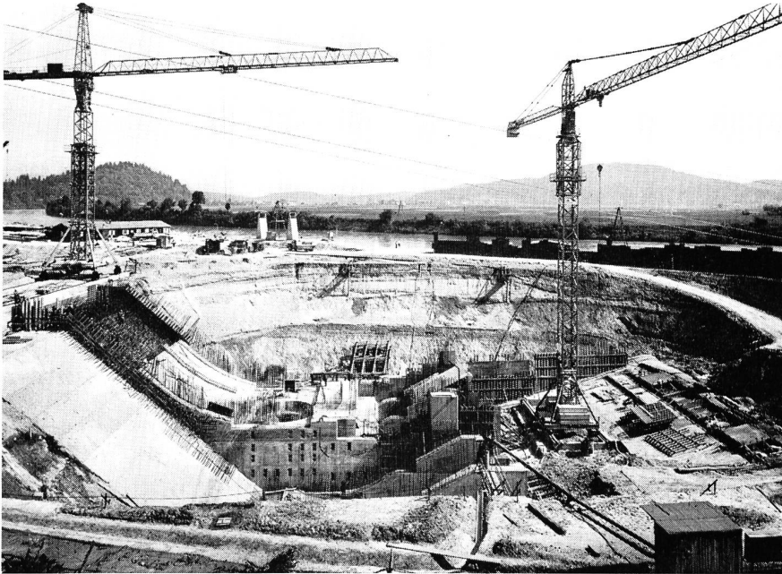
Bild 1 Die durch Grundwasserabsenkung trockengehaltene Baugrube für das Krafthaus Rosegg an der Drau (Werkphoto: Oesterreichische Draukraftwerke Aktiengesellschaft/Aufnahme Raab)
