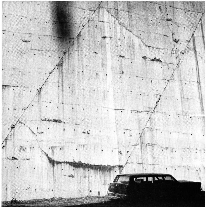
Bild 23 Typische Ausführungsmängel und Rissbildungen an der D. Johnson-Sperre
