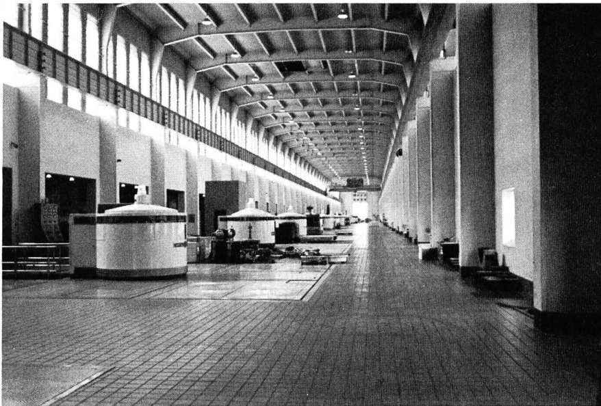
Bild 51 Blick in die Zentrale des kanadischen Kraftwerks Sir Adam Beck Niagara Generating Station Nr. 2
