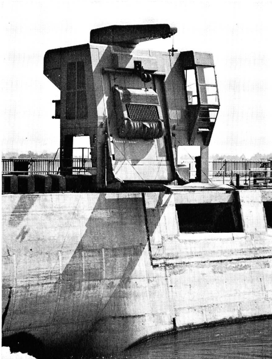
KW. Strassburg Rechenreinigungsmaschine mit Turmdrehkran
